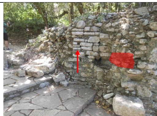
Figura 12. Pjesë e Murit 10, ngjitur me shtegun kryesor të vizitorëve që shkon nga Porta Perëndimore deri në Kala. Muratura ka boshllëqe dhe është veçanërisht e lirshme.
