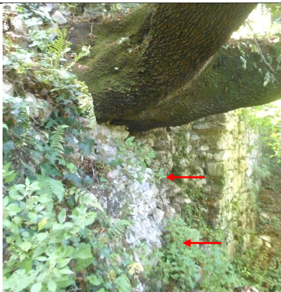
Figura 15. Në brendësi të kodrës, një pemë e madhe ka shkaktuar shembjen e faqes së jashtme të murit dhe tani bërthama është e ekspozuar ndaj degradimit nga agjentët atmosferikë.
