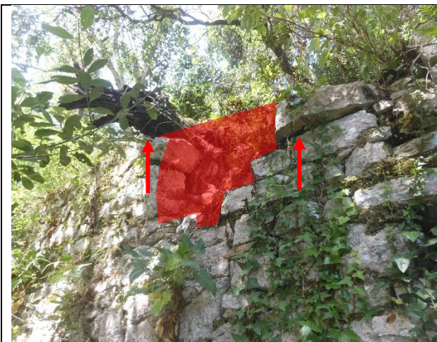
Figura 5. Shembje e pjesshme dhe blloqe të lirshme të muraturës për shkak të rrënjëve të një peme.
