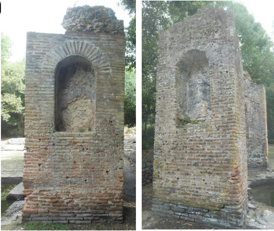
Figura 21 & 22 degradime dhe çarje të strukturës të evidentuara në pjesën e nisheve dhe në bazën e strukturës
