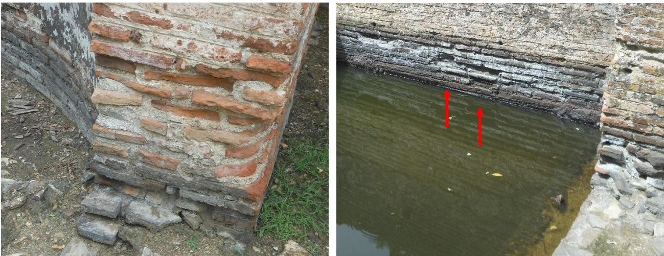
Figura 19 & 20 Erozion i fugave të llaçit dhe tullave në strukturat e gjimnazit
